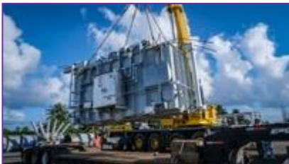
Subestación Eléctrica Trujillo Alto
