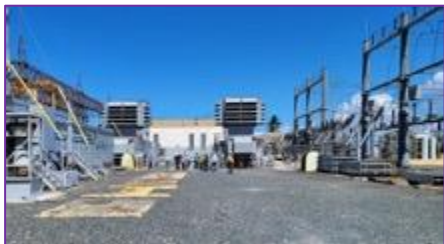
Mega Generadores Palo Seco
